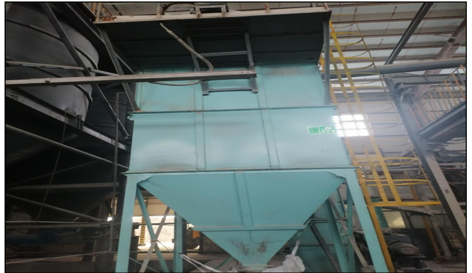
现有工程除尘器
